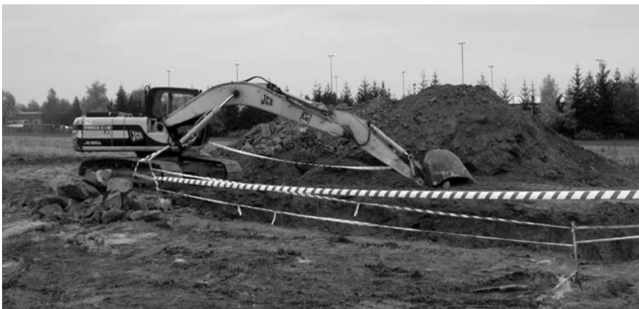
Na budoucím sídlišti rodinných domů Pod Tratí byly zahájeny výkopové práce pro uložení inženýrských sítí.
