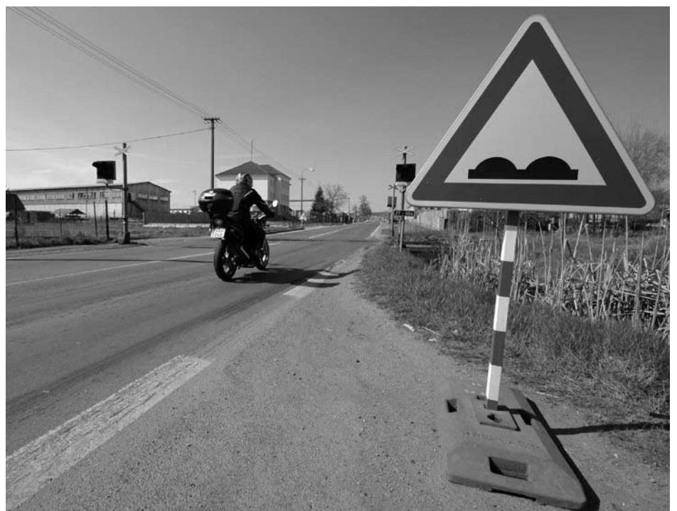
Není asi motoristy, který by si nezanadával při přejíždění železniční trati u kralovického nádraží. Správa železniční dopravní cesty Praha informovala, že oprava tohoto železničního přejezdu byla zařazena do plánu na druhé čtvrtletí tohoto roku. Měli bychom se tedy dočkat nápravy do dvou měsíců. Foto Jakub ROM
