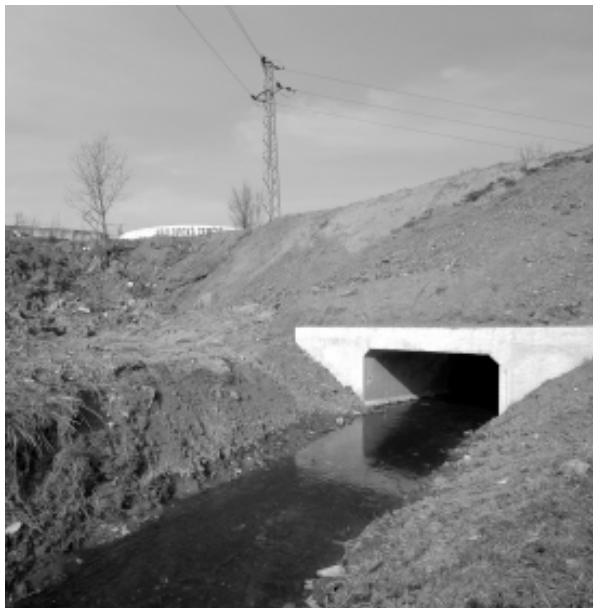
Rekonstrukce čistírny odpadních vod se chýlí ke konci a technologické zařízení se připravuje k uvedení do zkušebního provozu, který potrvá do konce letošního roku. Upraveno bylo i přemostění Kralovického potoka s přístupovou cestou k čistírně (na snímku), které již hrozilo sesutím. Jeho rekonstrukce si vyžádala náklady ve výši asi 700 000 korun. Foto Jakub ROM.
