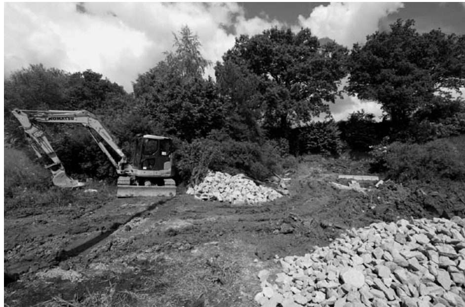
Po dokončení prací na rekonstrukci a odbahnění Voleského rybníka provádí firma STAVMONTA, s. r. o., Plzeň, v současné době i rekonstrukci hráze největšího z rybníků v majetku města, Olšanského. V jeho hrázi se objevila trhлина, která představovala nebezpečí v případě, že by se rybník zcela naplnil. Při opravě byly částečně odstraněny dřevěné konstrukce z počátku 18. století, kdy proběhla rozsáhlá přestavba hráze, pozoruhodné části dřevěného tesaného potrubí z té doby byly předány muzeu v Mariánské Týnici. Foto Jakub ROM
