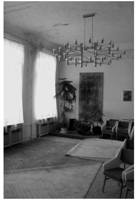
Obřadní síň na radnici, poškozená při průtrží mračen 22. července. Foto K. ROM
